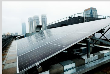
厦门分行大厦屋面光伏板
